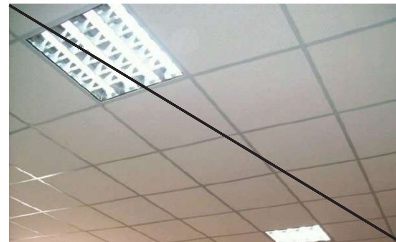
Плохо Открытые направляющие
